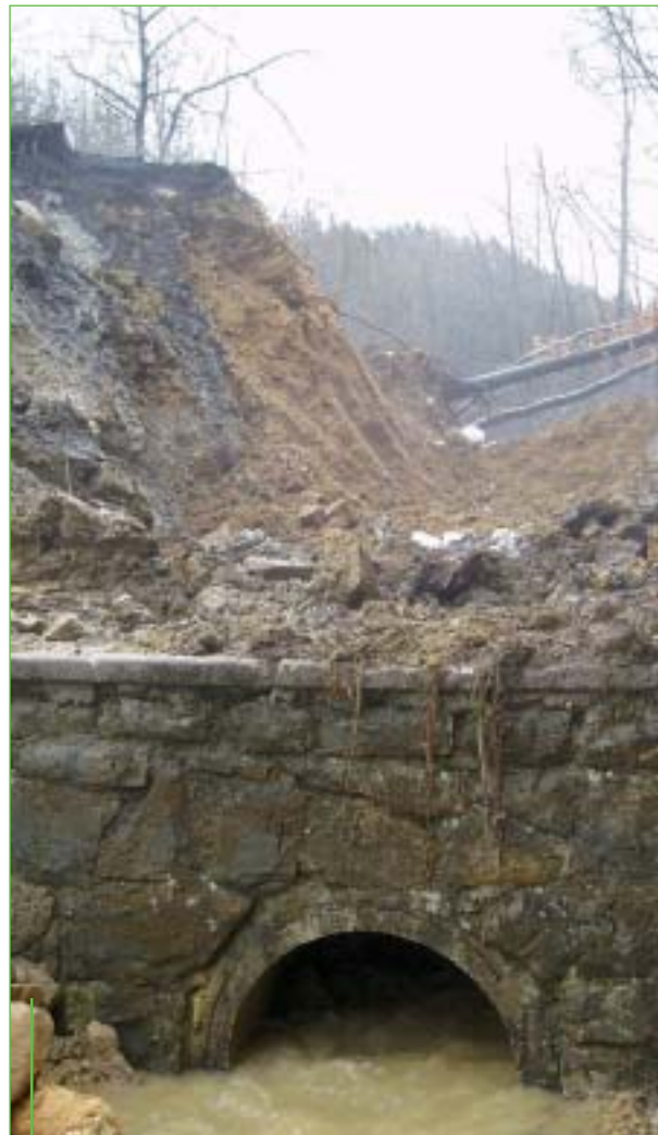
Poškozená propust Dlouhá – LS Luhačovice
